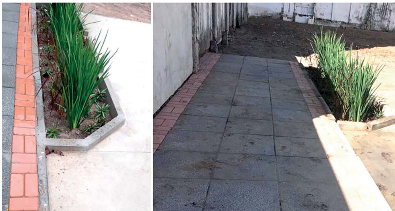
► Passeio e jardim de chuva intactos e funcionais após fortes precipitações. Fonte: Autores (2019).
